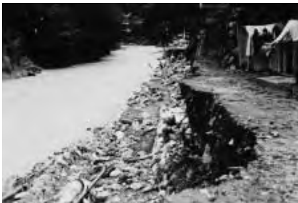
中奥川沿いの道路はこのとおり崩壊しました
