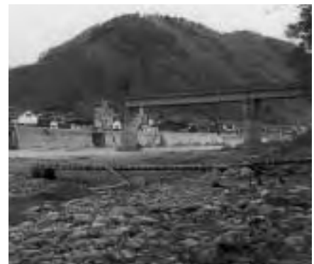
半分流された鉄筋の桜橋 (写真提供 吉野木材協同組合連合会)
