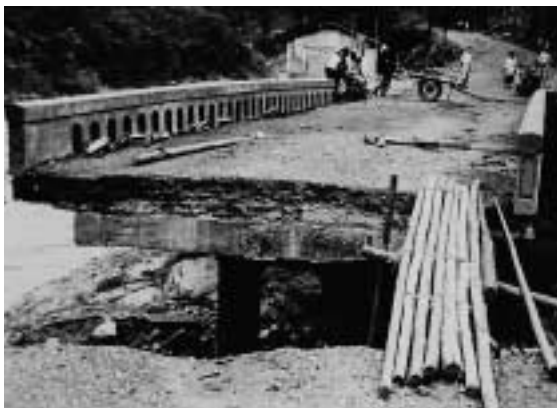
国道にかかる出合橋の被害
