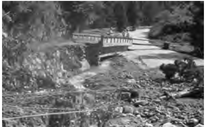
川底が埋まり、荒れた神之瀬橋
