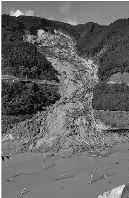
西谷（迫・寺尾）の土砂崩れ
